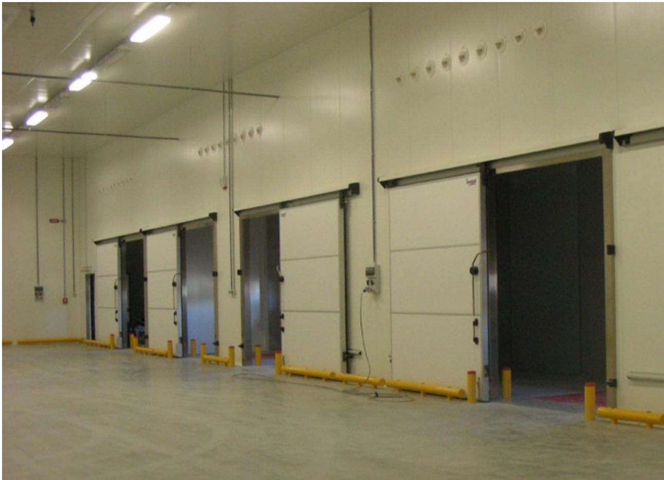
Separazione anticella-baie di carico
