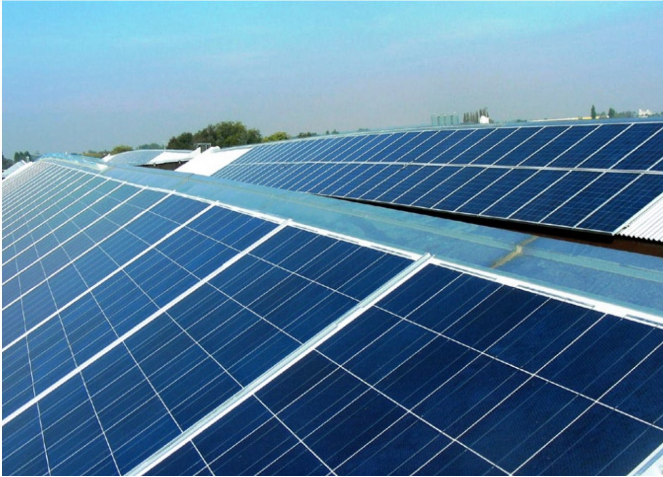
Impianto fotovoltaico in copertura
