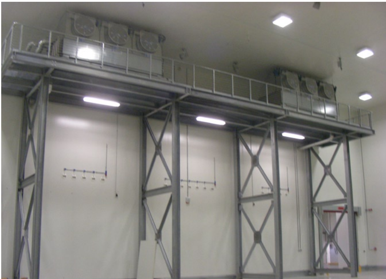
Soppalchi a sostegno degli aerorefrigeranti nella cella surgelati
